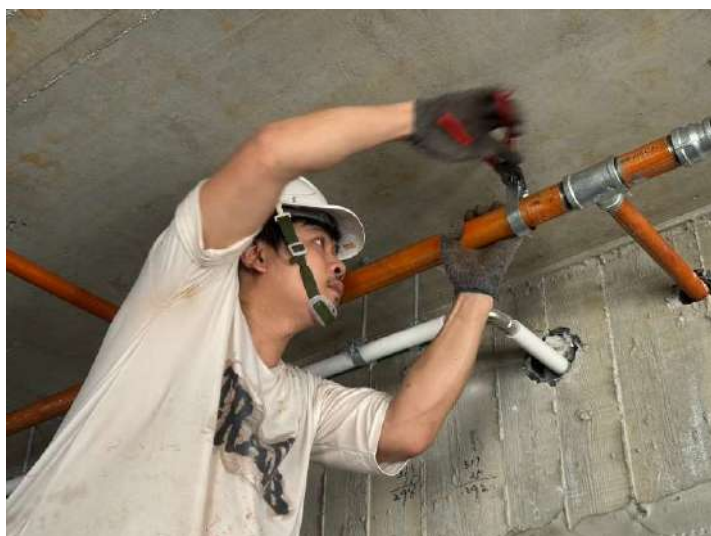
11F消防配管
